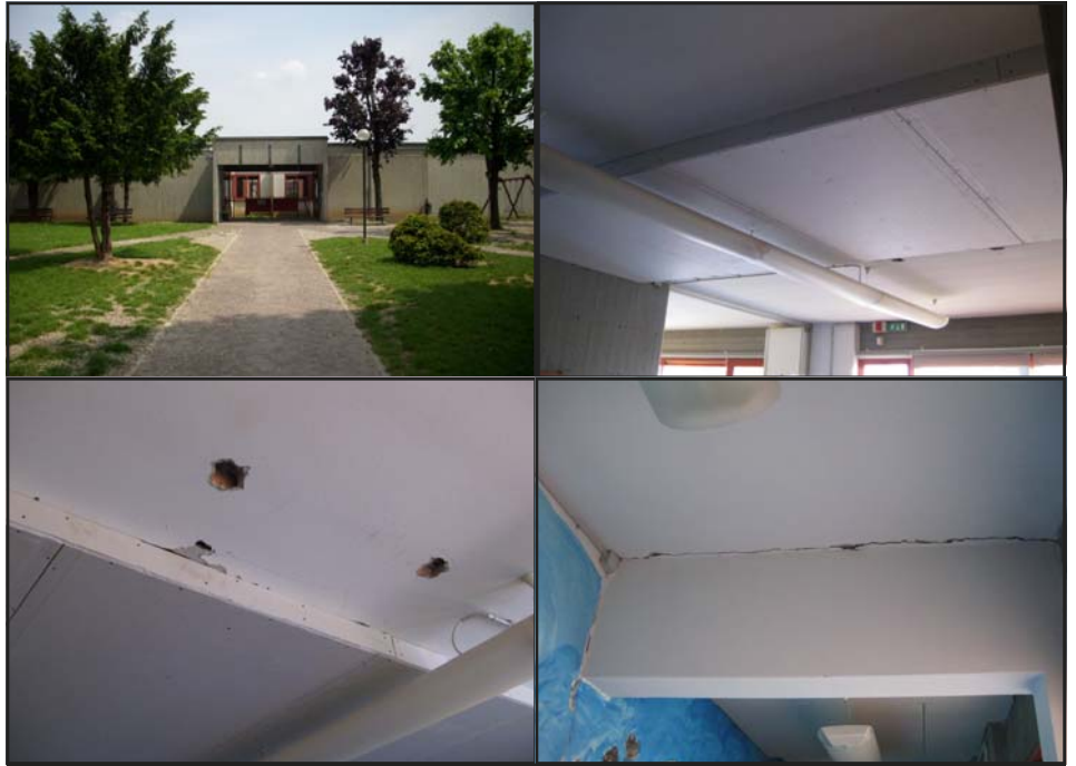
Figura 4. Tamponamenti provvisori sul soffitto della scuola materna
